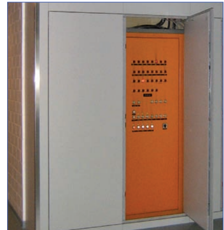
Anwendungsbeispiel: Betriebsraum für elektrische Anlagen, ohne feuerbeständiger Verglasung in der Tür (U-Form)
